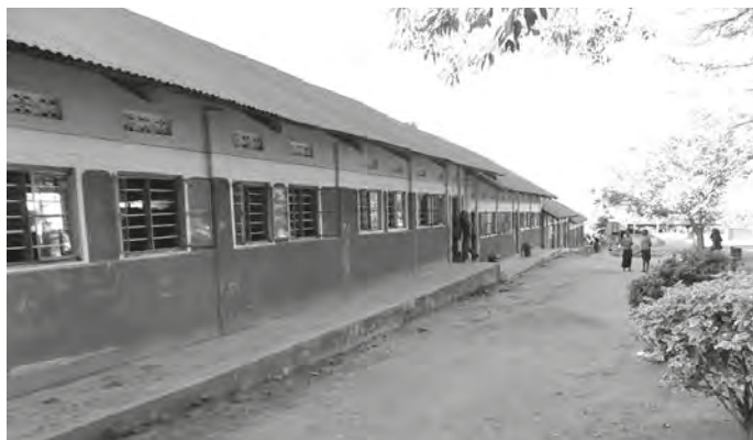
2017: Baufällige Gebäude an der St. Bruno Schule
